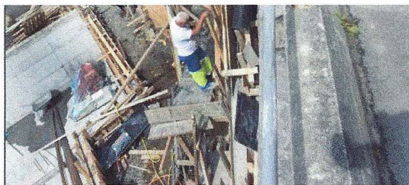
Vidar Larsen (til høyre) og Thor Åge Christiansen dokumenterer de manglende sikringstiltakene der forskalingsnekkerne jobber i opptil fire meters høyde.
